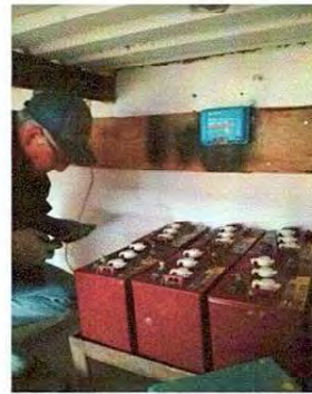
Panel solar y mantenimiento de baterias que lo alimentan
